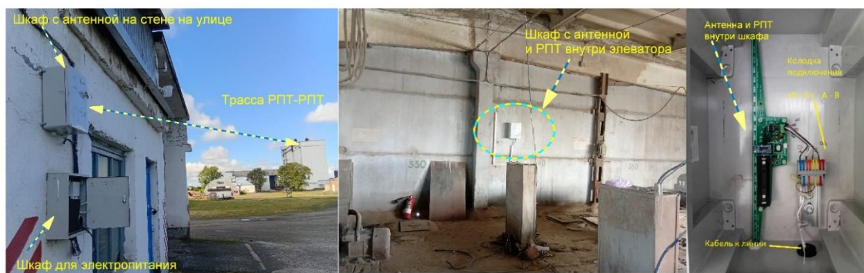
Рис. 2. Вид антенных шкафов
