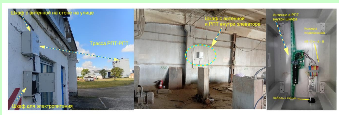
Рисунок 5. Вид антенных шкафов на элеваторе
