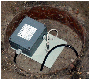
Рис. 4. Головка термоподвески в силосе элеватора.
